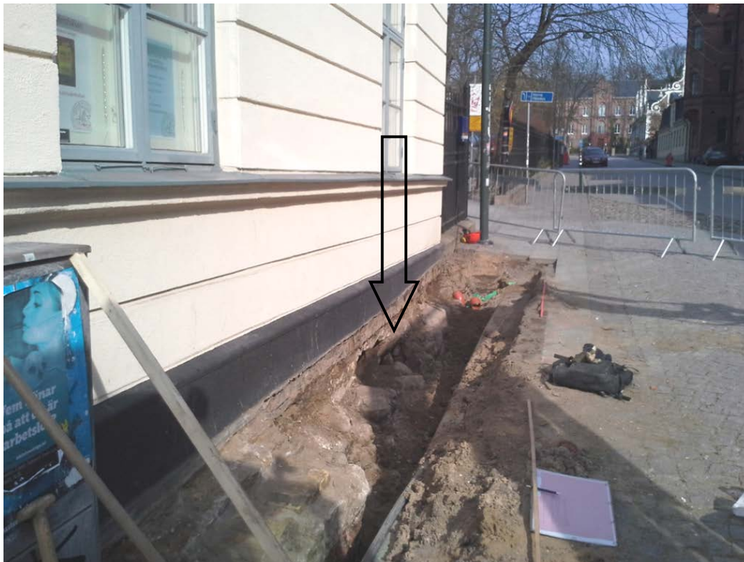
Figur 11. Östra gaveln uppvisade ett område med hålrum mellan sockel och grundmur samt flera stora stenar därunder med hålrum emellan cirka 1,10 m under dagens marknivå (pil). Troligen har det funnits en tidigare byggnad med källare på platsen. Fotografiet taget från söder.
