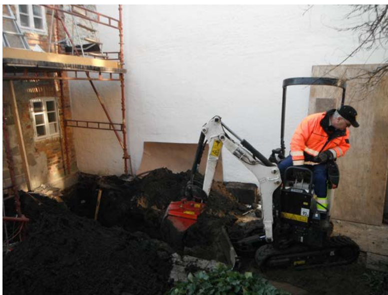
Figur 4. Schaktning mellan uthuset/förrådet (till höger) och gatuhuset (gatuhuset syns inte på fotografiet utan ska sökas höger om fotografiet). Fotografiet är taget från norr.
