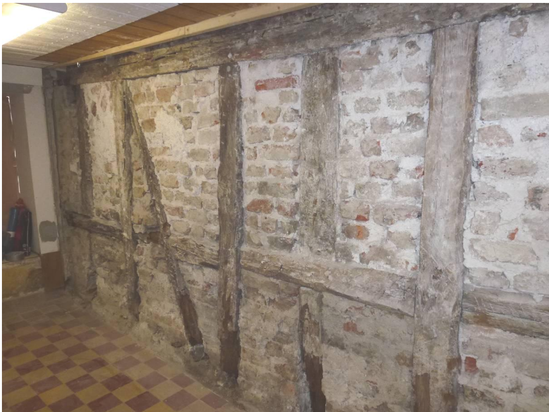
Figur 5. Före åtgärder. Södra gavelfasaden insida. Vy mot gatan i öster. Här har den gjutna syllen tagits bort. Stolparna står på blandade stenar och tegel direkt på marken.
