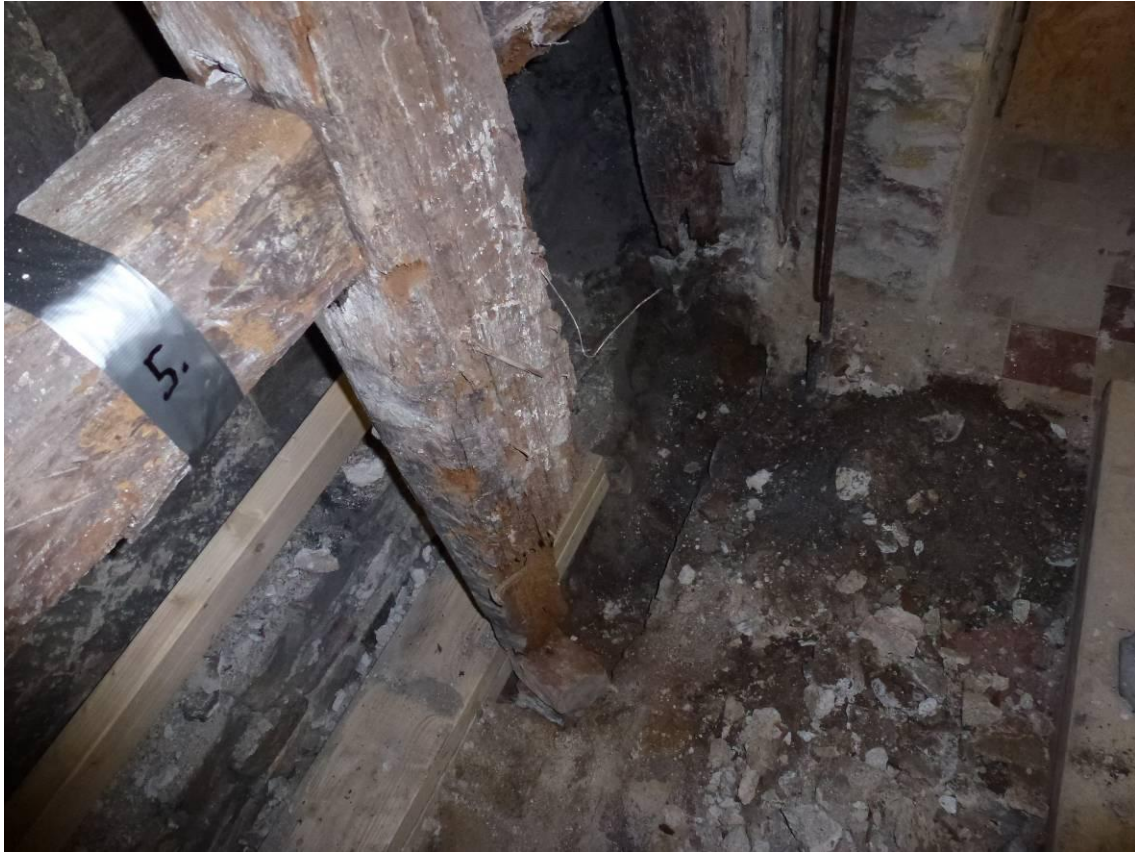
Figur 12. Stolparna var kraftigt rötskadade. De numrerades före nedmonteringen för att återanvändas i möjligaste mån. På bilden ser man sammanfogning löshult - stolpe och grunden under stolpen. Fotträ saknades helt och hållet.
