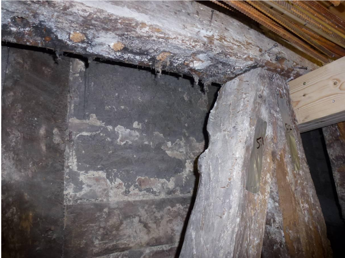
Figur 10. När även de övre fyllningarna plockats ner kunde man se hål och avbrutna stakar i undersidan av lejden. Väggen har alltså varit en klinevägg med stakar. Man kan jämföra med klineväggen Kulturen funnit i Tegnér-museet en byggnad från 1700-talet, Gråbröder 15, Lund, under restaurering 2012.
