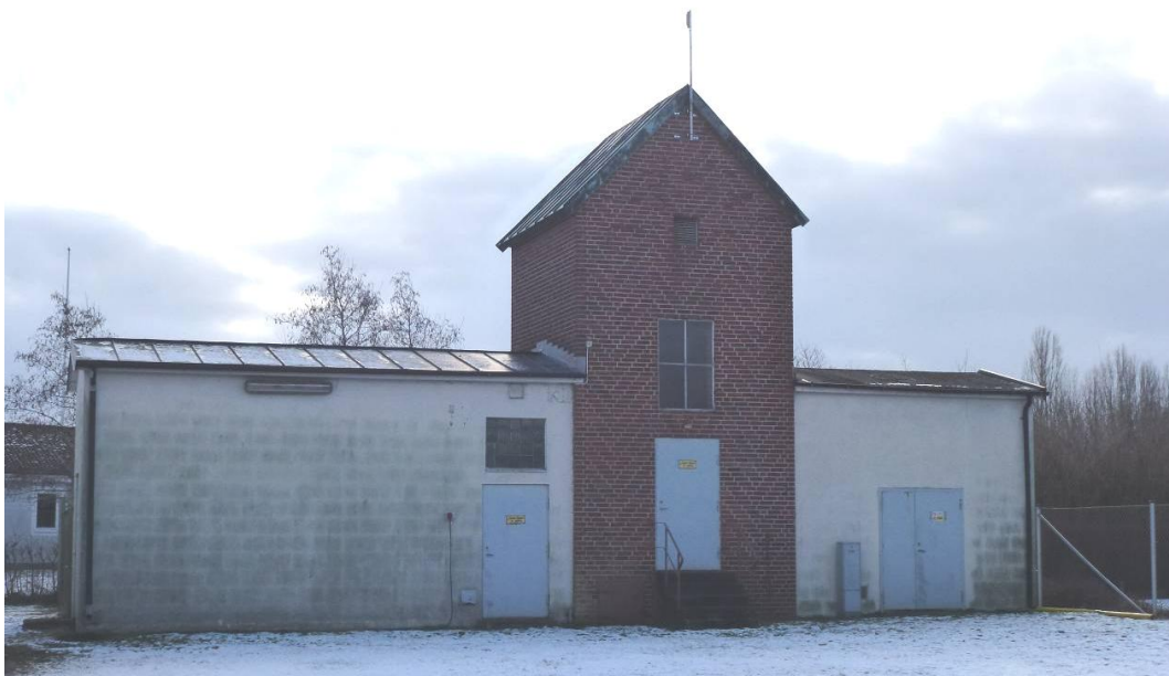
Transformatorstation på Sugnässlan 7, Södra Sandby.
