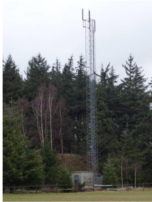
Fristående mast med teknikbod i Björnstorp.
