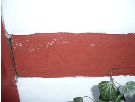
Numrering på lös-bult, norra fasaden.
