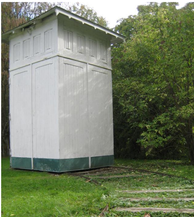
Mindre skada vid takfot
