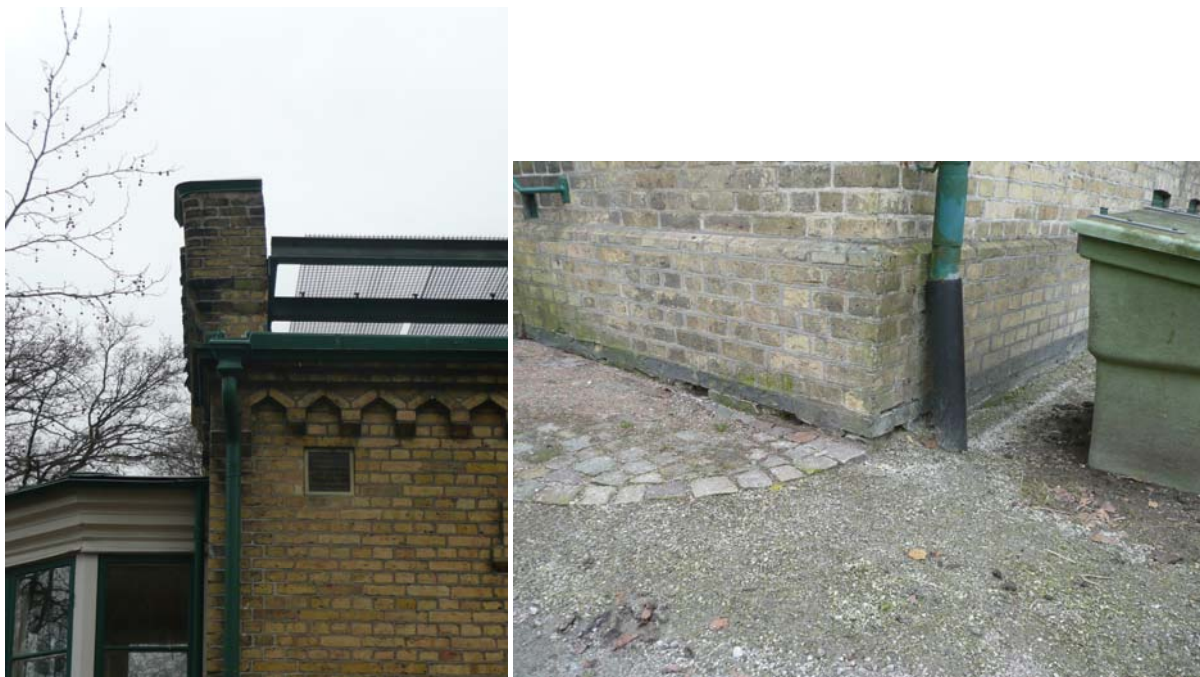
Murkrön på östra flygeln lutar något. Tegel eroderat vid marknivå.
