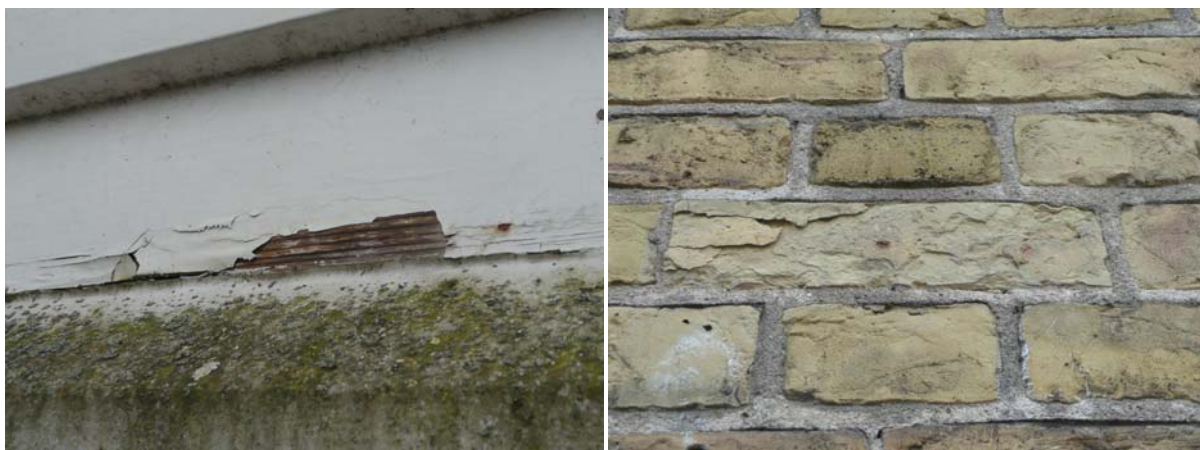
Plastfärg på trä binder fukt och släpper i sjök. Mycket få fasadtegel är eroderade, fogarna har troligen varit utformade som åsfog ursprungligen.
